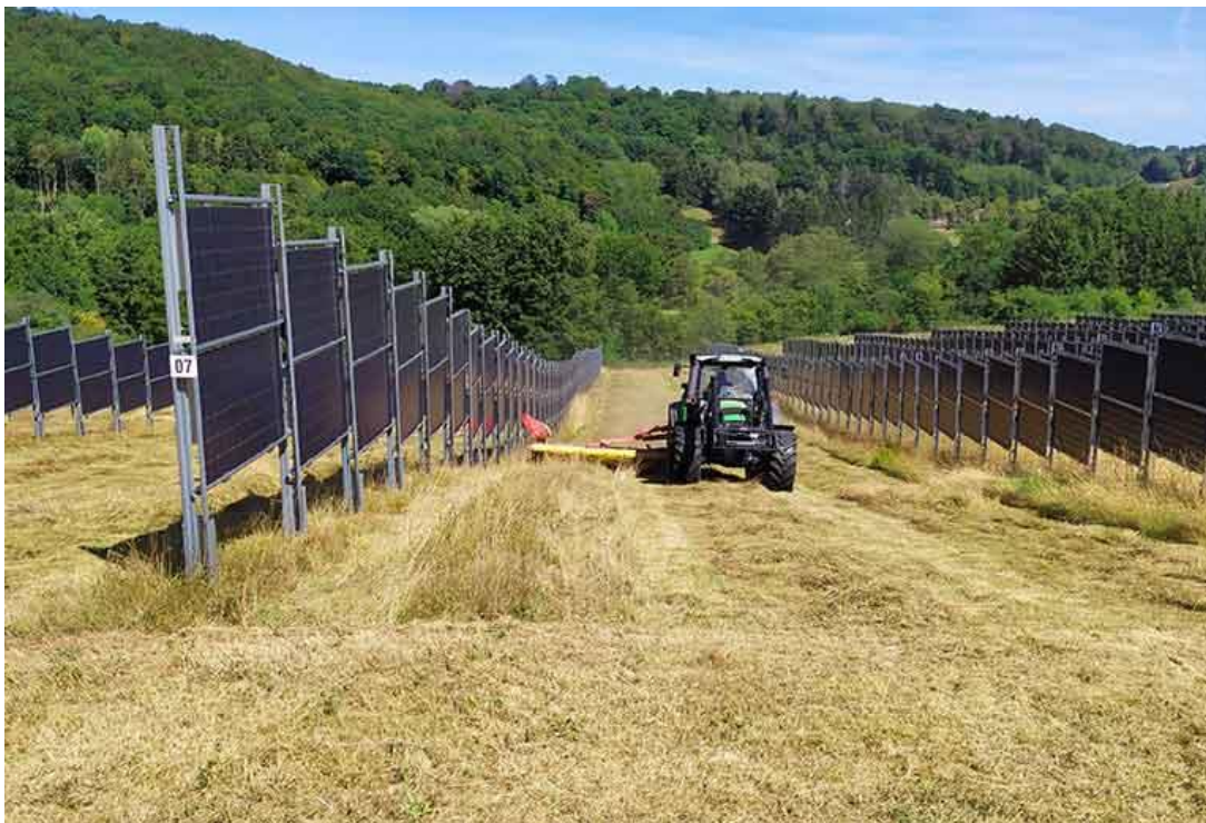
Abbildung 6: Foto einer bifacialen Freiflächenphotovoltaikanlage, next2sun
