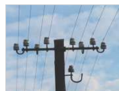
über Freileitung bis ca. 1980
